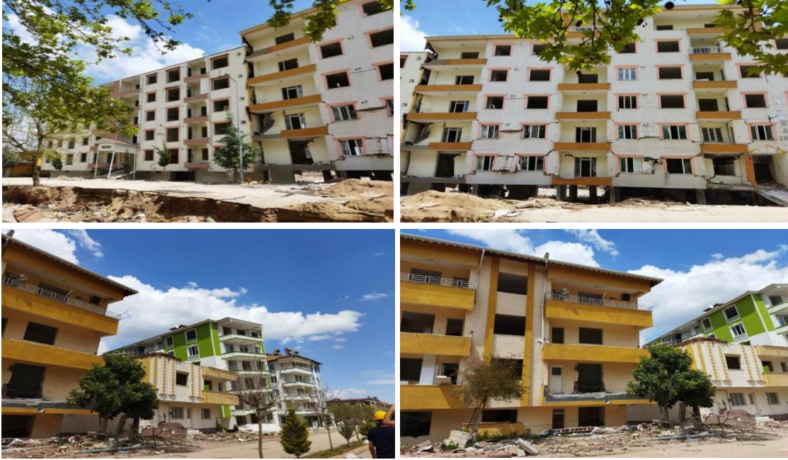
Şekil 5: Yapısal hasar örnekleri
