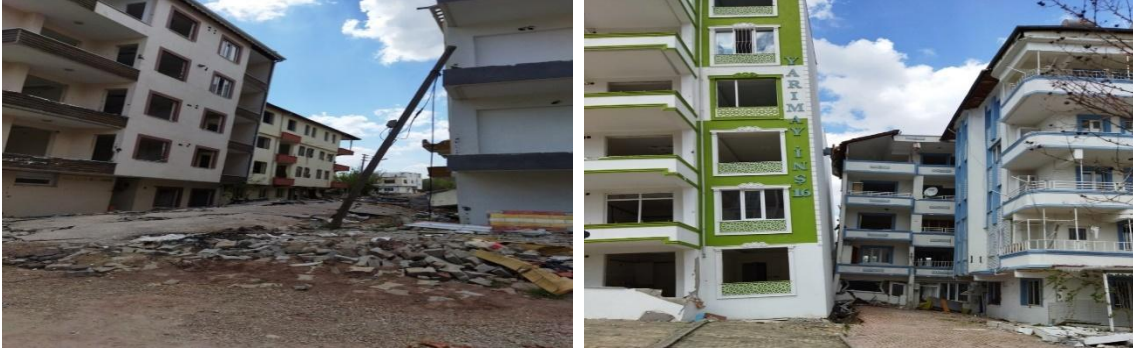
Şekil 7: Bina çökmeleri (sıvılaşmadan kaynaklı yolların yükselmesi)
