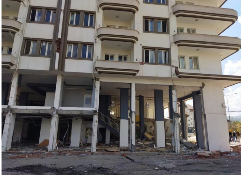
Şekil 11: Binada yapısal hasar örneği
