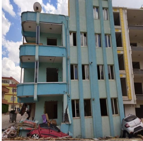
Şekil 6: Zemindeki sıvılaşmadan dolayı yapı oturması
