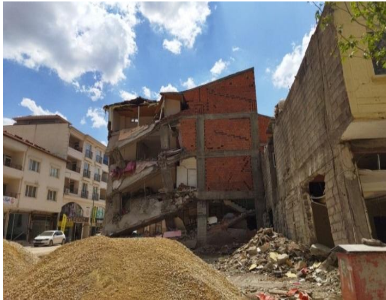
Şekil 9: Taşıyıcı sistemin yıkıldığı bir yapı örneği
