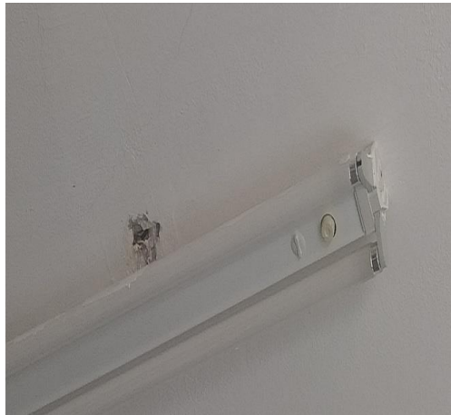
Şekil 5. MDBF binasının acil durum aydınlatması Figure 5. Emergency lighting of the MDBF building
