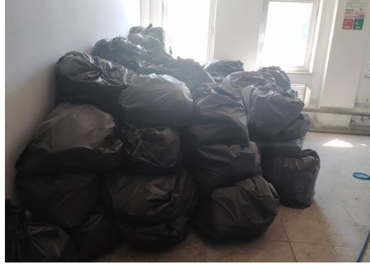
Şekil 7. MDBF binası kazan dairesi görünümü Figure 7. MDBF building's boiler room
