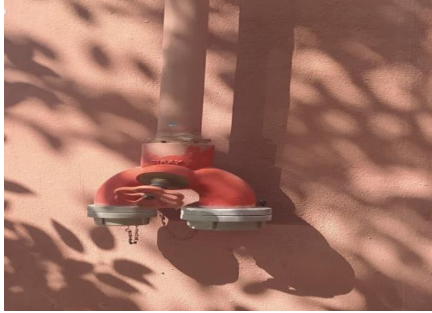
Şekil 11. MDBF binası yangın dolapları Figure 11. Fire cabinets in the MDBF building
