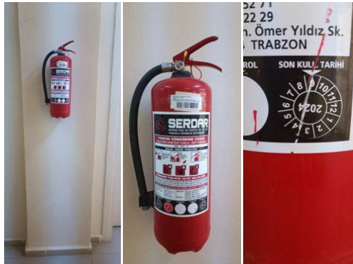
Şekil 13. MDBF binası taşınabilir söndürme cihazları Figure 13. Portable fire extinguishers in the MDBF building
