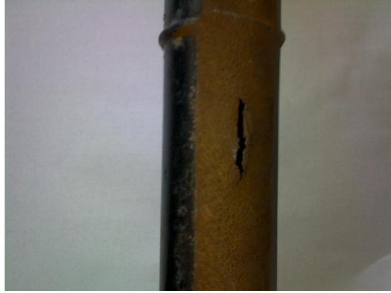
Şekil 1. Kül aşındırması sonucu oluşan boru yırtılması
