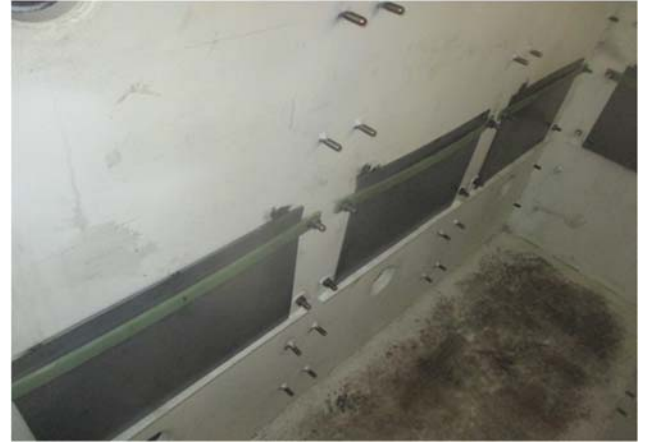
Şekil 9. Test-1'de kullanılan şönt elemanların kazan içerisindeki yerleşimi (View of shunt packages, arranged in Test-1)
