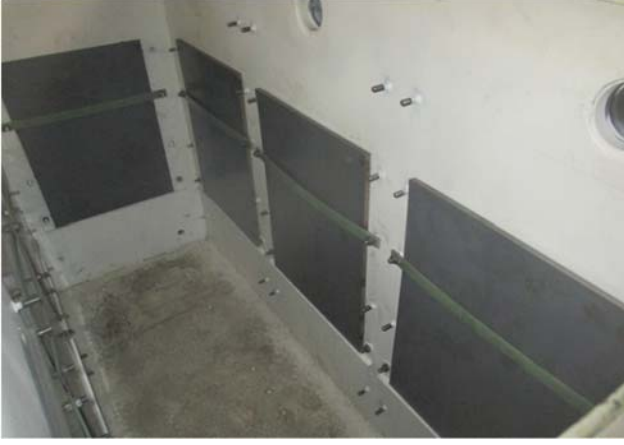
Şekil 10. Test-1’de kullanılan şönt elemanların kazan içerisindeki yerleşimi (View of shunt packages, arranged in Test-4)
