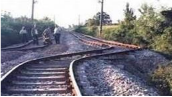
Şekil 2. 1999 Kocaeli Depremi'nde hasar gören demiryolu üstyapısı
