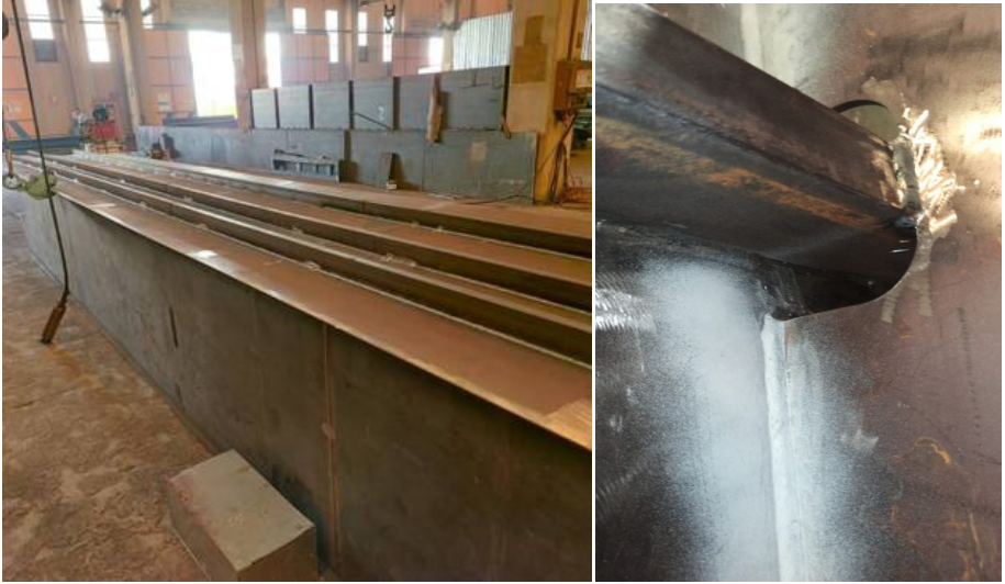
Şekil 3. Vinç Sistemlerinde Kutu Kiriş Çelik Konstrüksiyonu Güçlendirme Takviyesi (Stiffener, Soldaki Görsel) Ve Güçlendirme Plakası (Stiffener Plate, Sağdaki Görsel) Sürekli (Aralıksız) Kaynaklı Birleştirme Hatalı İmalat Detayı Görünümü
