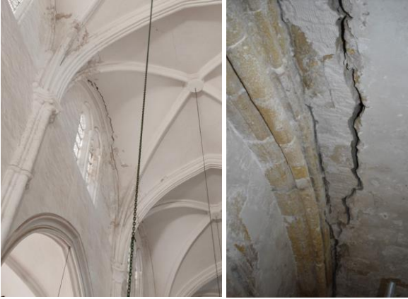
Şekil 9. Tonozlar- orta nef beden duvarı birleşim bölgesinde oluşan çatlak ve ayrılmalar.
