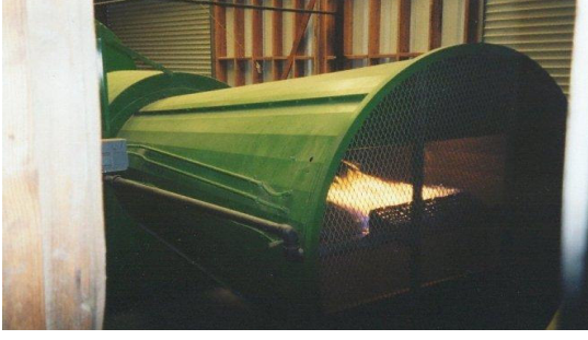
Şekil 23. Yakıcı ünitenin yanma sırasındaki görünüşü. Figure 23. View of burner unit during combustion.
