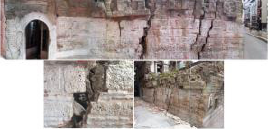
Resim 20. Abdullah Paşa Sıbyan Mektebi, Batı Cephesi, Çatlak, Hatıl ve Konsol İzleri (MDM Mimarlık Proje Tasarım ve Antika Müzayede Tic. Ltd. Şti. Arşivi, Haziran 2016).
