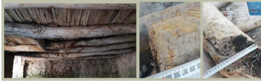
Şekil 12. Konutta Kullanılan Ahşap Kirişlerdeki Bozulma ve Esnemeler.
