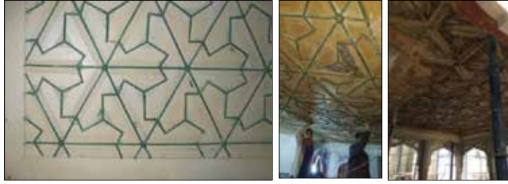
Görsel 7. Müezzin mahfilinin restorasyon öncesi durumu (İstanbul Vakıflar I. Bölge Müdürlüğü).
