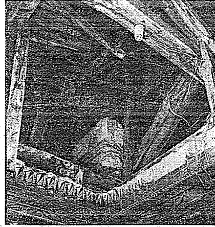
Resim 21. Çatı arasındaki yıkık beşik tavan boşluğu.
