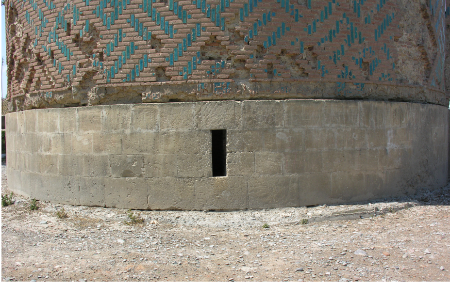
Resim 11. Berde Türbesi. Gövdenin alt kenarından geçen kitabe kuşağı.
