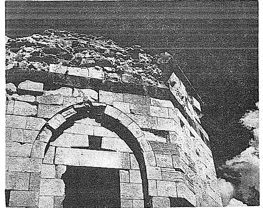
Resim 8. Türbenin örtü sistemine geçiş kısmındaki silme kalıntıları.
