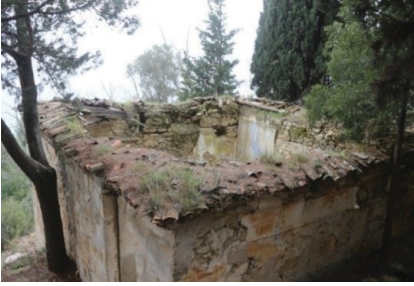
Şekil 40. Yıkılmış türbe çatısı (2023)
