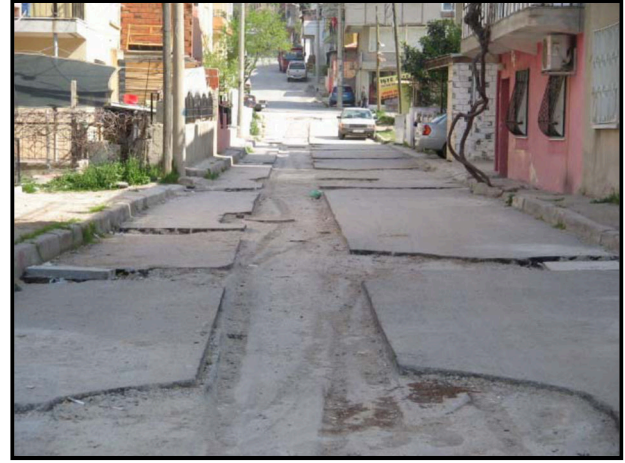
Şekil 1. Koordinasyonsuz bir kazı çalışması örneği [9] (An example of incoordinated excavation)
