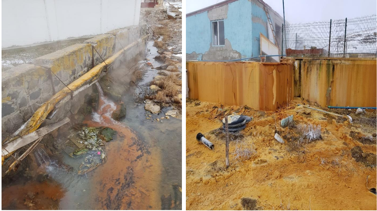
Şekil 2. Jeotermal Suyun Hasar Oluşturduğu Yapılar
