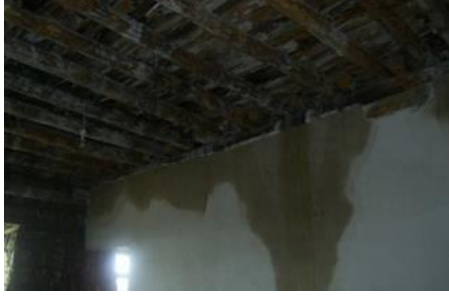
Fotoğraf 3. Aşhane kısmında görülen tahribat
