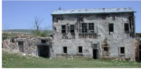
Fotoğraf 1. Mihrali Bey Konağı onarım öncesi (Fotoğraf, 2004), İl Özel İdaresi İmar Bölümü.
