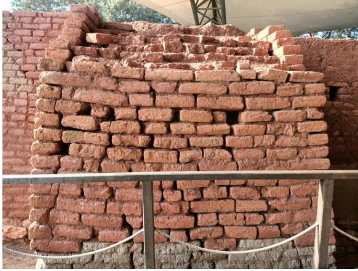
Resim 7: Troya II-III Kale duvarının fiziksel bozulma görseli, 2023 (Dikenci, 2024: 61).
