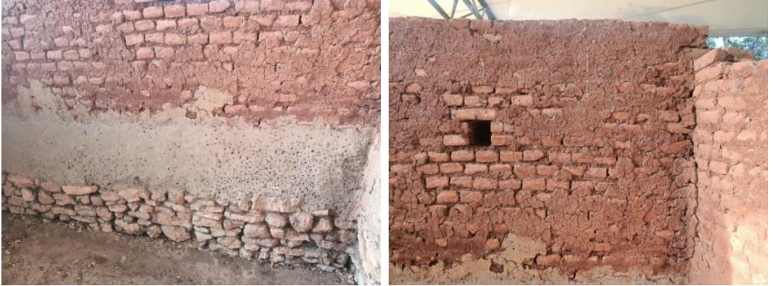
Resim 6: Troya II-III Kale duvarı sıvasında oluşan kırılma ve parçalanma detay görselleri, 2023 (Dikenci, 2024: 63).
