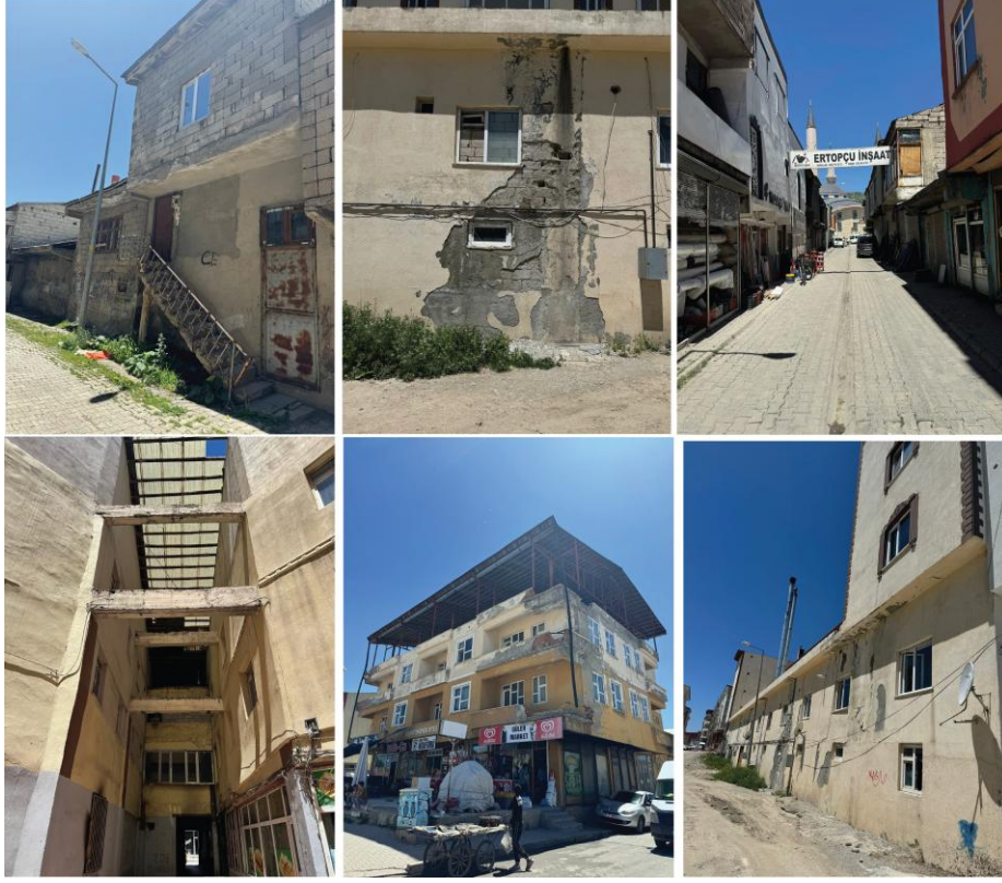
Şekil 10. Çaldıran ilçesinde yer alan kötü yapı kalitesine sahip binaların genel görünümü.
