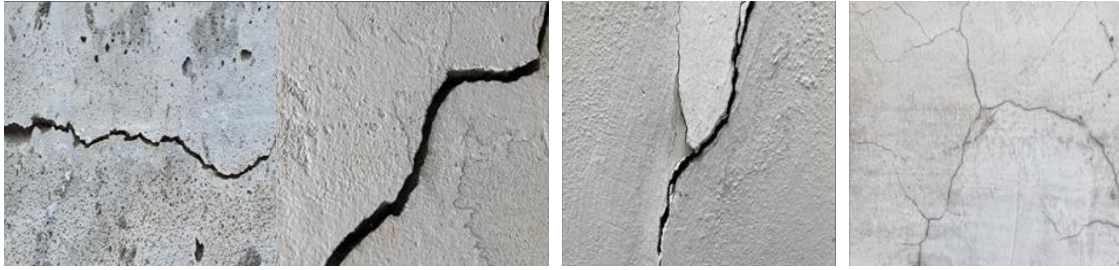
Şekil 1. CRACK veri seti beton çatlak görüntüsü örnekleri [14].
