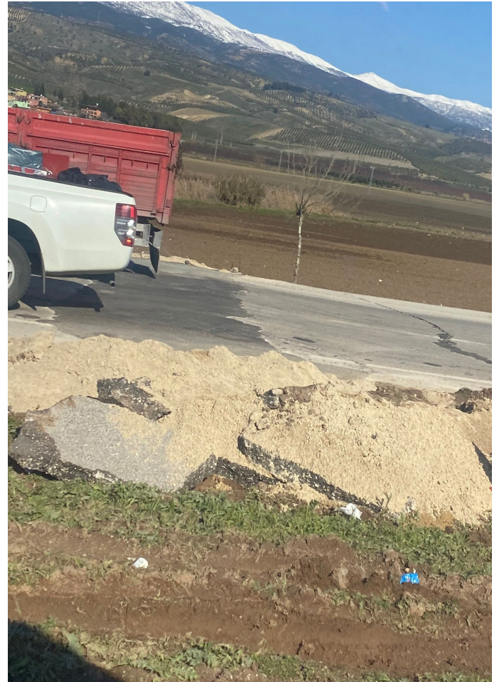
Şekil 5. Yollarda Meydana Gelen Çökmeler.
