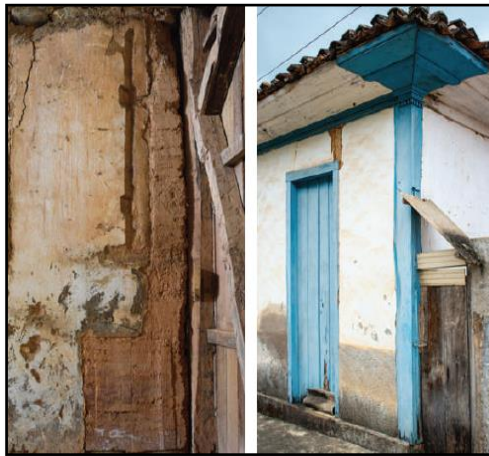
Şekil 10: Yapılarda meydana gelen bozulmalardan malzemelerin okunuşu (Dias & Cardoso,2023).
