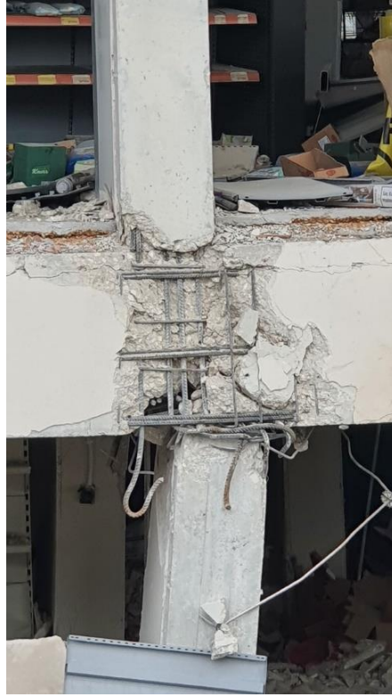
Şekil 11. Ağır Hasarlı Kolon-Kiriş Birleşimi
