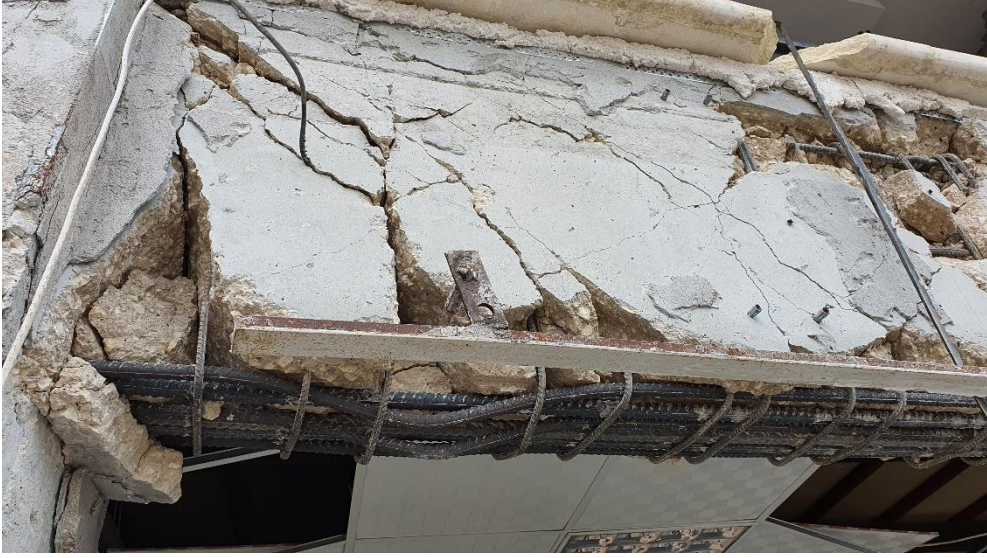
Şekil 13. Kirişte Kesme Hasarı Figure 13. Shear Failure in a Beam
