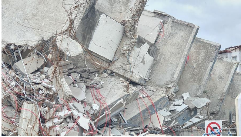
Şekil 8. Devrilmiş Bir Yapı
