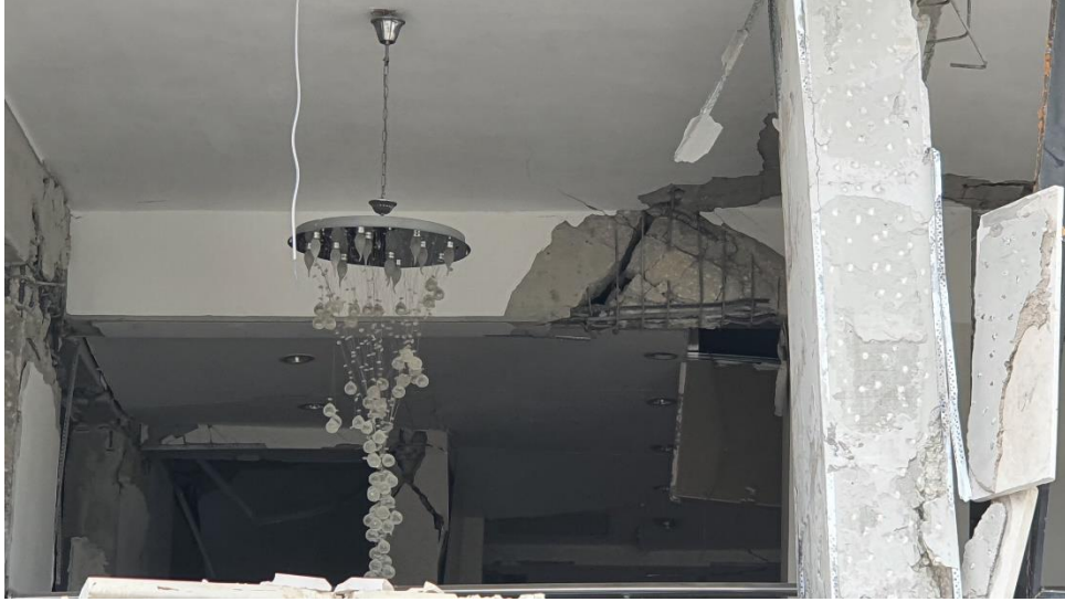
Şekil 14. Kirişte Kesme Hasarı Figure 14. Shear Failure in a Beam
