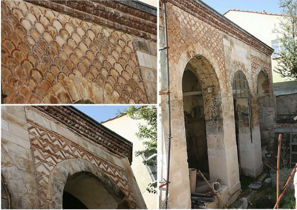
Görsel 8: Restorasyon esnasında kuzey cephede açığa çıkan tuğla dekorasyon
