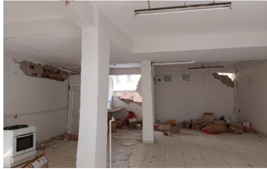
Şekil 10. Zemin katta belirgin hasar almayan kolonlar.
