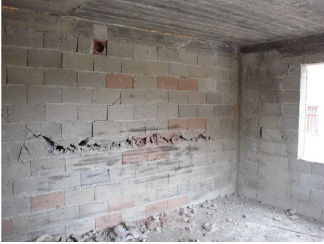
Şekil 8. Örnek Yapı 2'de taşıyıcı yığma duvar çatlakları
