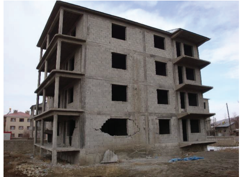
Şekil 6. Örnek Yapı 2 genel görünüşü, 23 Ekim 2011 Tabanlı, Van Depremi'nden hemen sonra
