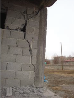
Şekil 7. Örnek Yapı 2'de düşey hatlardan yığma duvara sirayet eden kesme çatlakları
