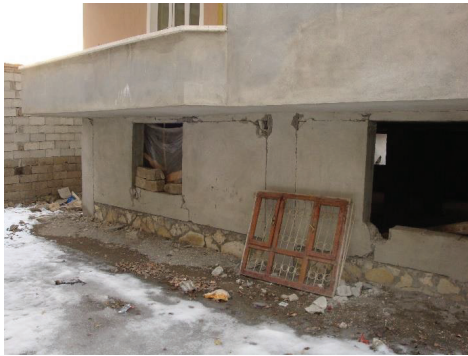
Şekil 4. Örnek Yapı 1 giriş katı, 23 Ekim 2011 Tabanlı, Van Depremi'nden hemen sonra
