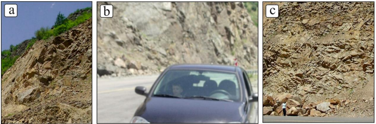
Şekil 3. Gümüşhane-Giresun yol kazı şevlerinde ayrıtlanan bazı jeoteknik birimler; a) 3. jeoteknik birim, b) 5. jeoteknik birim, c) 11. jeoteknik birim
