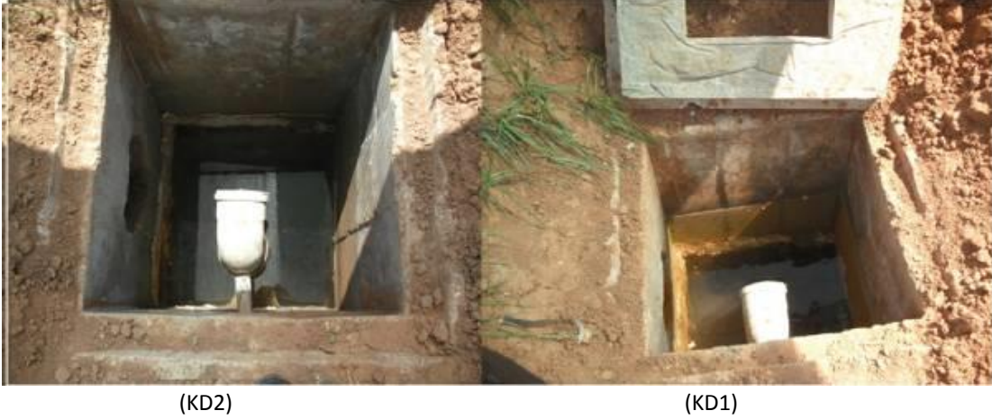
Şekil 5. Manholde su yükseltici kontrol yapılarının görünümü
