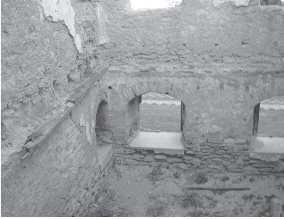
Resim 12 : Bodrum ve zemin kat arasındaki kat arası döşeme izleri, yanmış döşeme kirişi parçası.
