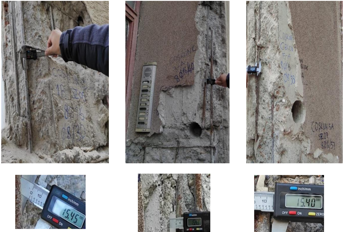
Şekil 13. Coşkun Sitesi C Blok pas payı sıyırma işlemi yapılan kolon donatılarında kumpas ölçümleri (bodrum kat)
