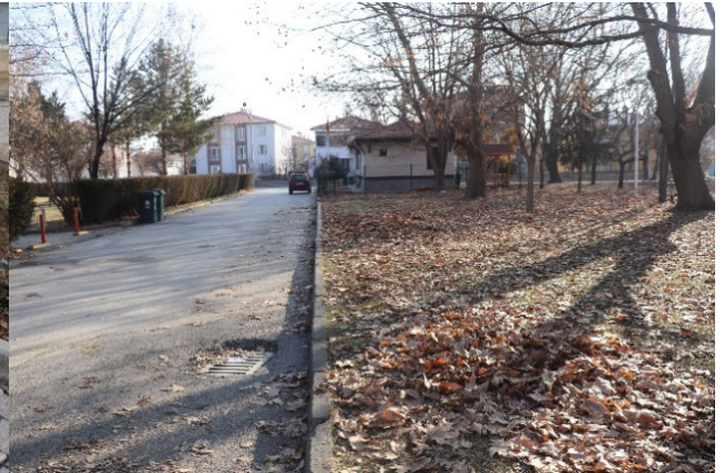
Şekil 13. Kaldırım bulunmama durumu
