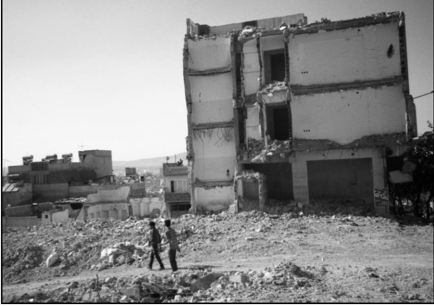
Fotoğraf 6: Gaziantep-Şahinbey-Kahvelipınar'da yıkım
