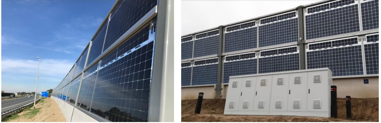
Şekil 8. PVGB sistemi ve invertör kabinleri (B istasyonu) [56].
