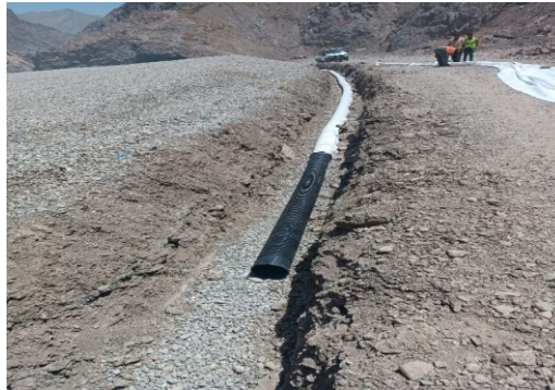
Şekil 8. Rehabilitasyon alanında sızıntı suyu toplama sistemi.
