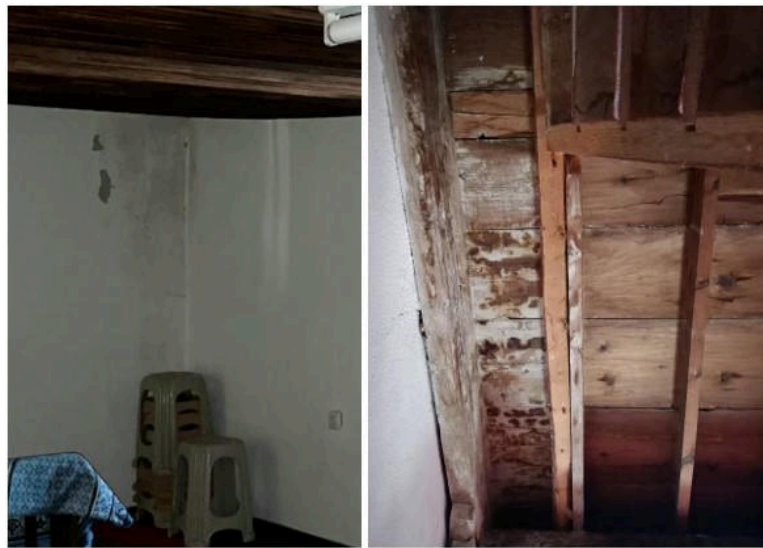
Görsel 29: Gölköy Köyü Şeyh Ahmet Camii güneybatı cephesinde gözlemlenen rutubet-nem izi ve sıva dökülmeleri (sol); Kasaba Köyü Mahmut Bey Camii mahfil katı rabita tahtalarında gözlemlenen nem etkisi sonucu mantarlaşma (sağ)
