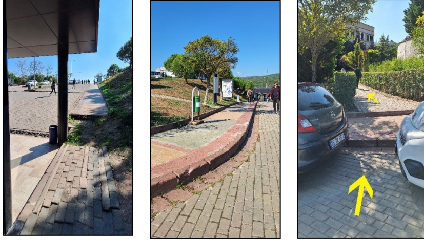
Şekil 15. B Kapı Girişi- Eğitim Fakültesi Dört Yol Kavşağı Kaldırım Çıkış ve İnişi (Yazar tarafından hazırlanmıştır. Yazar arşivi, 2025)
