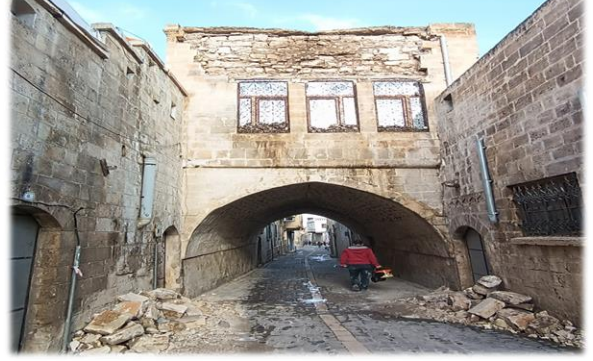
Görsel 4b: Depremde Hasar Gören Kurtuluş Mahallesi Karamusa Sokak Kabaltısı.
