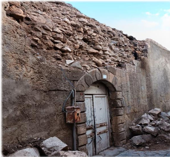
Görsel 8a: Yıkılan Kapı Girişi Kemer, Kurtuluş Mahallesi 1059. Sokak.
