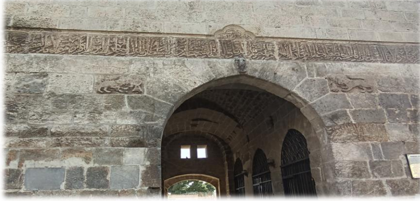
Görsel 8c: Taş Bloklarında Çatlaklar Görülen Harran Kapı Kitabesi ve Semboller
