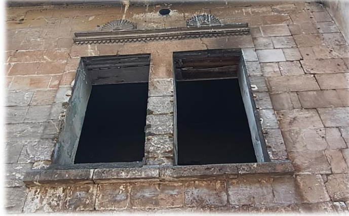
Görsel 7c: Hasarlı Taş Süslemeli Pencere, Yeni Mahallesi Güllü Sokak.
