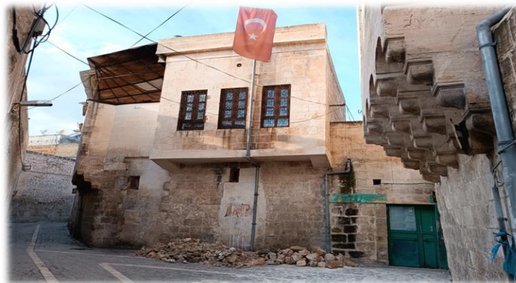
Görsel 9a: Depremde Hasar Almış Eski Urfa Evi, Beykapusu Mahallesi 933. Sokak.
