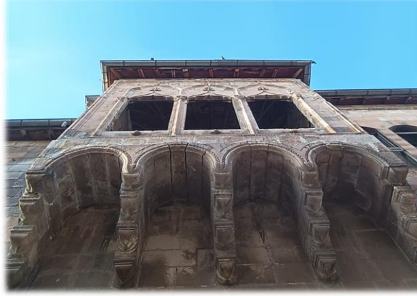
Görsel 6c: Hasarlı Çıkma Örneği, Beykapusu Mahallesi 992. Sokak.
