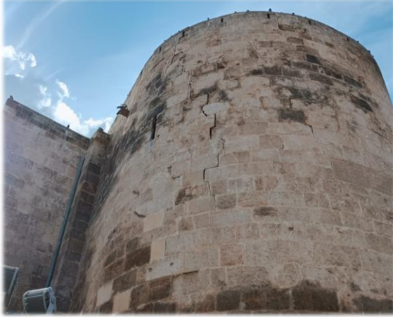
Görsel 18a: Deprem izleri, Mahmutoğlu Kulesi.
