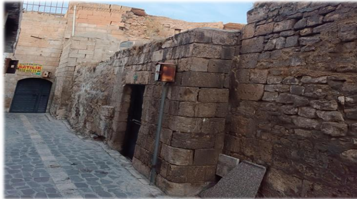
Görsel 5a: Üst Duvarın Hane İçine Çökmesi, Bıçakçı Mahallesi 1268. Sokak.
