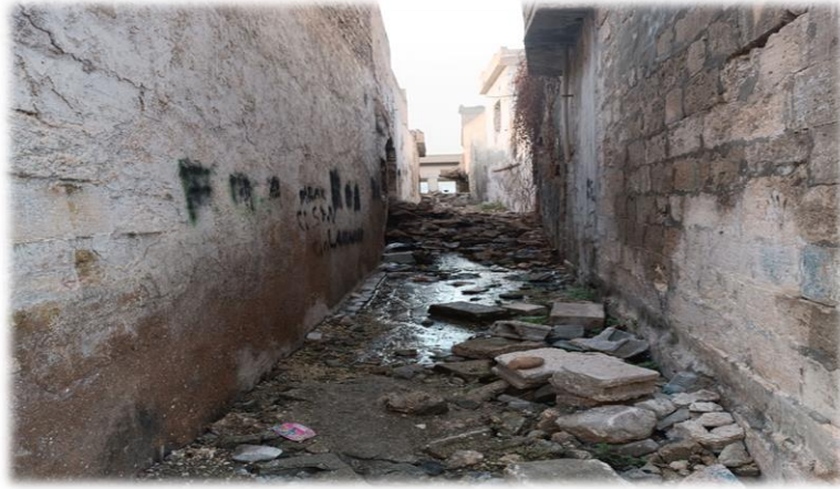
Görsel 3a: Depremde Girilemez Duruma Gelen Yeni Mahallesi 1277. Sokak.
