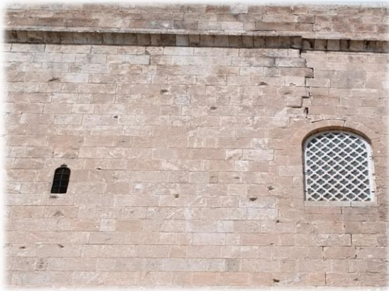
Görsel 7a: Hasarlı İbadethane Penceresi, Selahaddin Eyyübî Camii.
