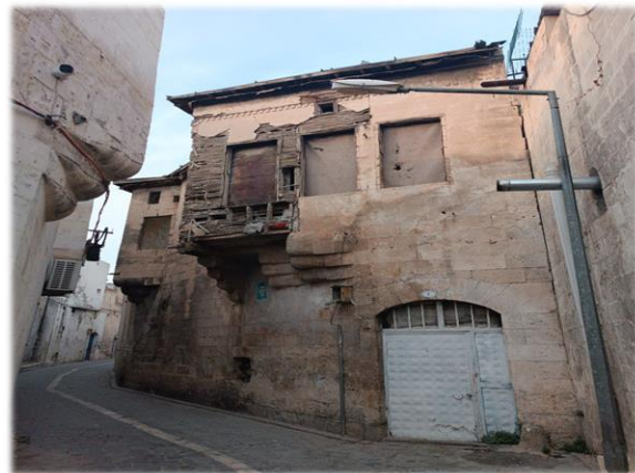
Görsel 6b: Hasarlı Çıkma Örneği, Hakimdede Mahallesi Hakimdede Sokak.
