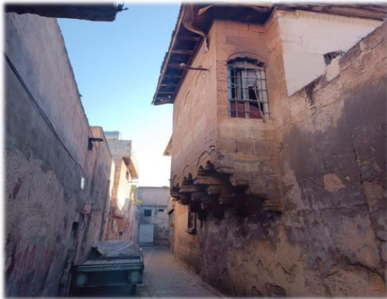
Görsel 6a: Hasarlı Çıkma Örneği, Kurtuluş Mahallesi 1043. Sokak.
