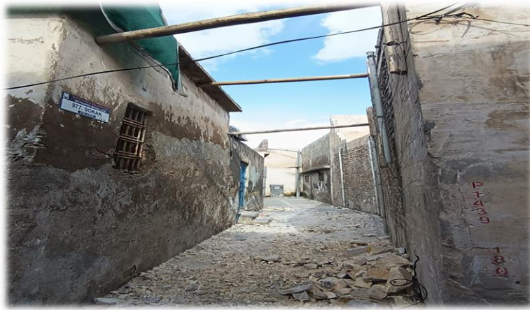
Görsel 3b: Depremde Girilemez Duruma Gelen Beykapusu Mahallesi 977. Sokak.
