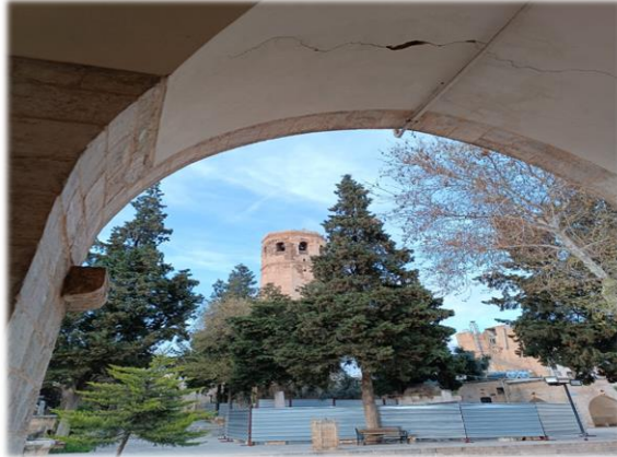
Görsel 12a: Son Cemaat Yerinde Oluşan Hasar, Ulu Cami.
