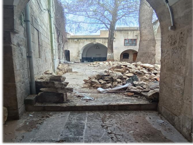
Görsel 12d: Dabakhane Cami'nin Avluya Çöken Duvarları.
