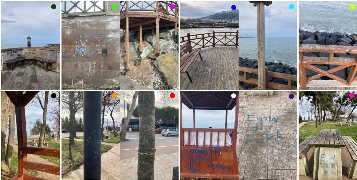
Şekil 8. Alan 3'te karşılaşılan vandalizm zararlarına örnekler (•, •, •: Yazma, boyama ve çöp atılan oturma grupları; •, •: aydınlatma direğine yazı yazma; •: ahşap korkuluğa yazma, kazıma eylemi; •: çöp atma; •: yer döşemesine yapılan yazı yazma eylemi; •: kayalıklara yapılan boyama eylemi; •: yetişkin ağaçlara yapılan kazıma eylemi; •: köprü altındaki duvara yazma, boyama eylemi; °: cankurtaran gözlem kulesine yapılan yazma eylemi).
