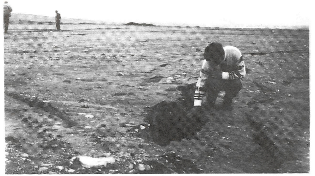
Şekil 12 Ekşisu Madensuyu tesisleri yanındaki suni dolgu zeminde gelişen oturma yapılarındaki açılma çatlığı (çekim kuzeybatıdan güneydoğuya).
