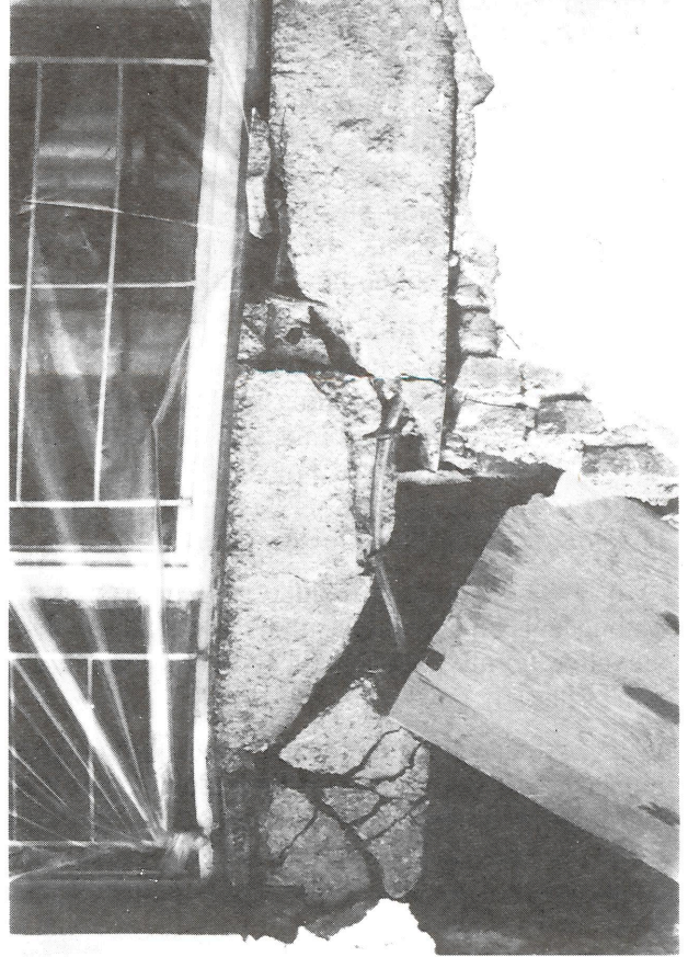
Şekil 21 Erzincan şehir merkezinde hasar görmüş çok katlı bir binanın kolonuna ait demirdeki deformasyon ve betondaki makaslaşma çatlakları (çekim güneyden kuzeye).
