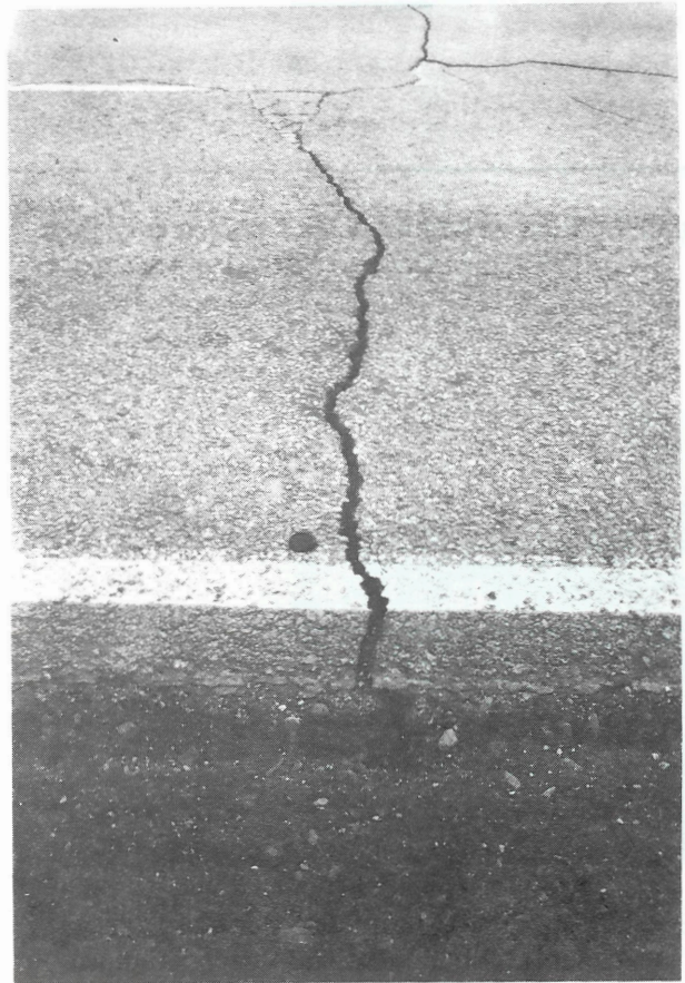
Şekil 14 Erzincan-Erzurum otoyolunda yola dik gelişen bir çatlak (çekim kuzeyden güneye).
