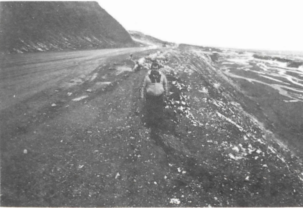
Şekil 13 Refahiye-Erzincan otoyolunda yola paralel gelişen oturma çatlakları (çekim kuzeybatıdan güneydoğuya).
