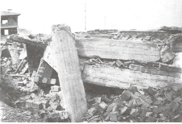
Şekil 19 Erzincan güncybatısındaki bir kooperatifte tamamiyle yıkılmış çok katlı bina. Burada da görüleceği gibi ilk hasar gören kısım kolon kiriş bağlantılarıdır. Yapılar genellikle güneye doğru yıkılmıştır.
