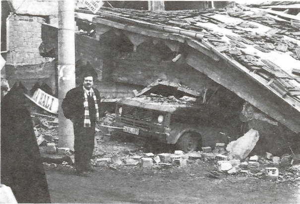
Şekil 20 Erzincan şehir merkezinde zayıf olan birinci katın çökmesiyle yıkılmış çok katlı binalardan biri (çekim güneybatıdan kuzeydoğuya).
