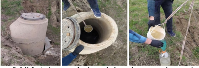
Şekil 3. Atıksuyun alındığı şebeke noktası ve atıksu temin süreci.
