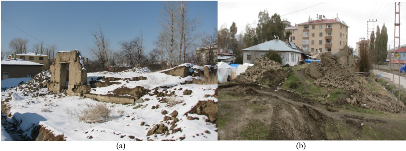
Şekil 11 (a, b). Tahir Paşa Konağı 2011 Deprem Sonrası Görünüşleri (Kaynak: Ş. Öztürk, 2011)
