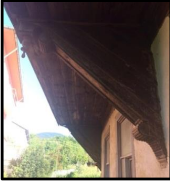
Foto 33: 3 no'lu konut konsol detayı
