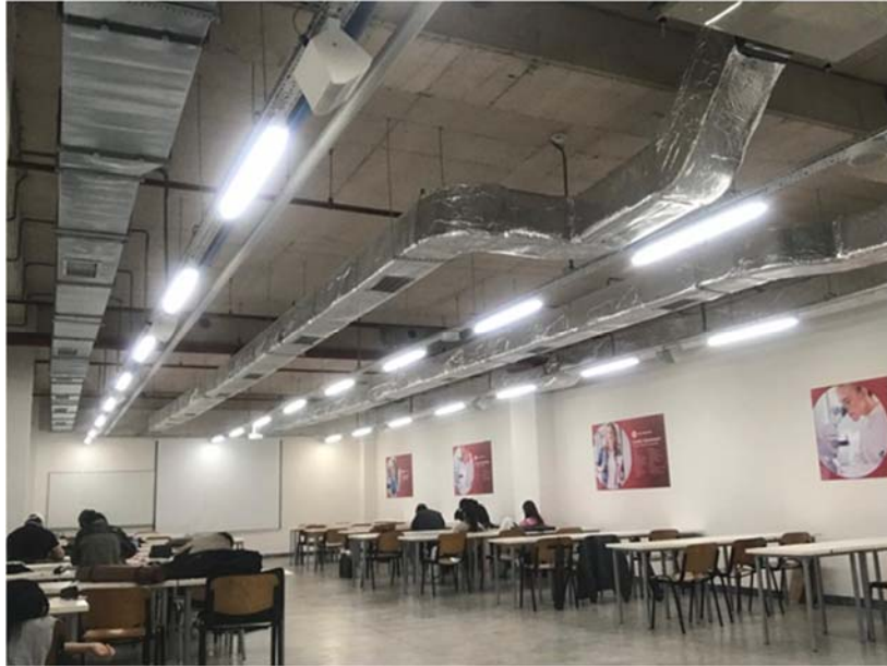
Şekil 2. Dersliğin genel görünümü (General view of the classroom)
