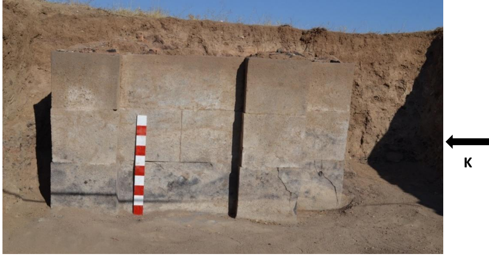
Şekil 7. Fil ayağındaki çatlamlar ve yangın izleri
