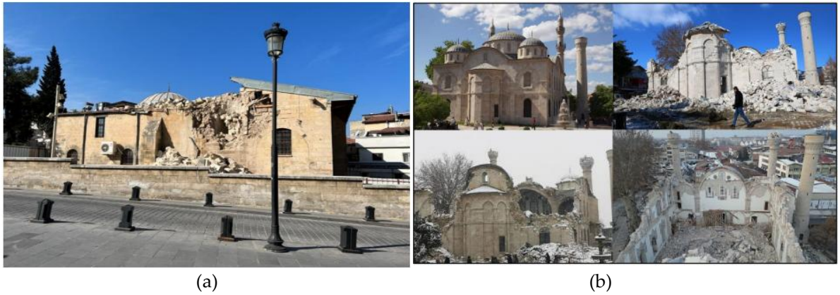
Şekil 2: 6 Şubat 2023 depremlerinde hasara uğrayan camiler; (a) [19], (b) [11].
