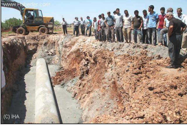
Şekil 3.4 Yüksek basınca dayanamayıp patlayan CTP sulama boruları, Şanlıurfa Bozova Borulu Sulama Şebekesi,.
