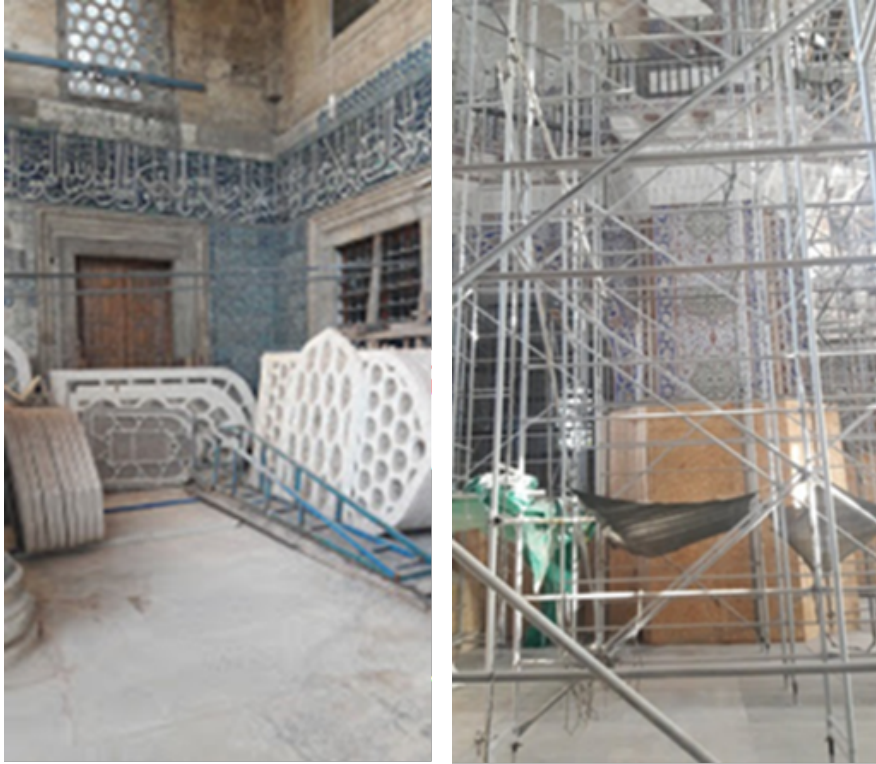
Resim 6: Yapı içerisinde hatalı yerleştirme (sol taraf) Yapı içerisinde iskele kurulumu (sağ Taraf) (Yeni Cami, İstanbul)
