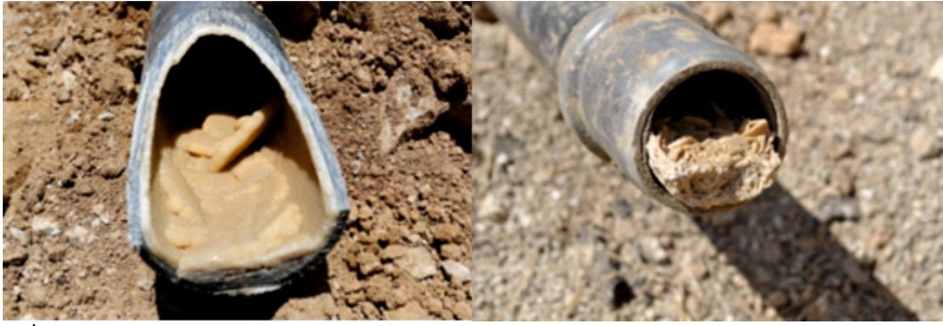
Şekil 6. İçme suyu iletim borularında meydana gelen kabuklaşma (Scaling in drinking water transmission pipes)
