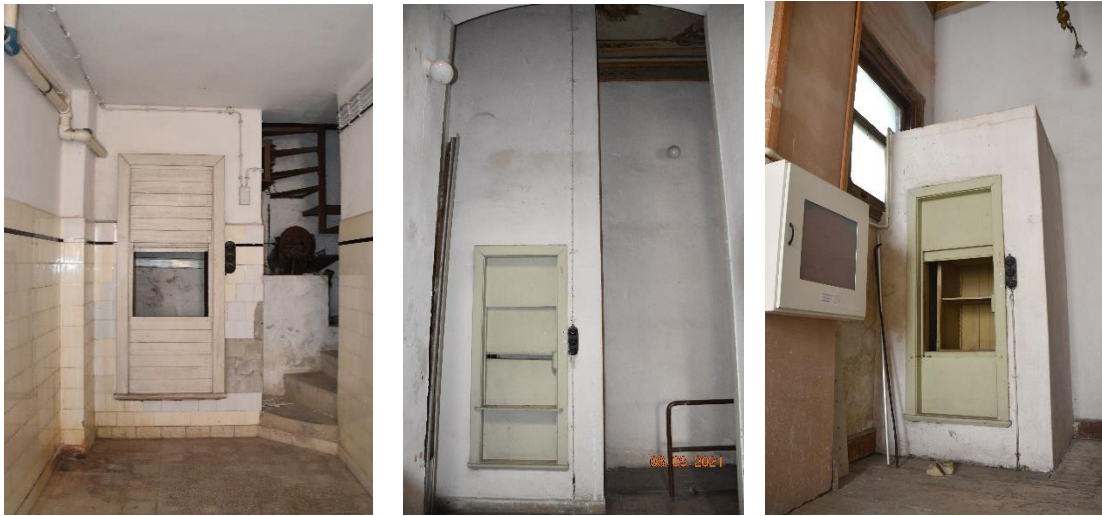
Şekil 13. Bodrum Kat, Zemin Kat ve Birinci Kata Ulaşan Yemek Asansörü (Foto: Han, B.)
